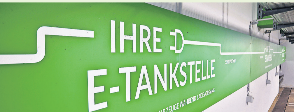
Zukunft und Tradition in Einem: Der Nürnberger Südwestpark bietet Unternehmen flexible Flächen mit eigener Planung. Nachhaltigkeit auf allen Ebenen wird groß geschrieben, der Strom weitgehend selbst erzeugt. Und die Verkehrsanbindung ist perfekt. Fotos: Südwestpark
